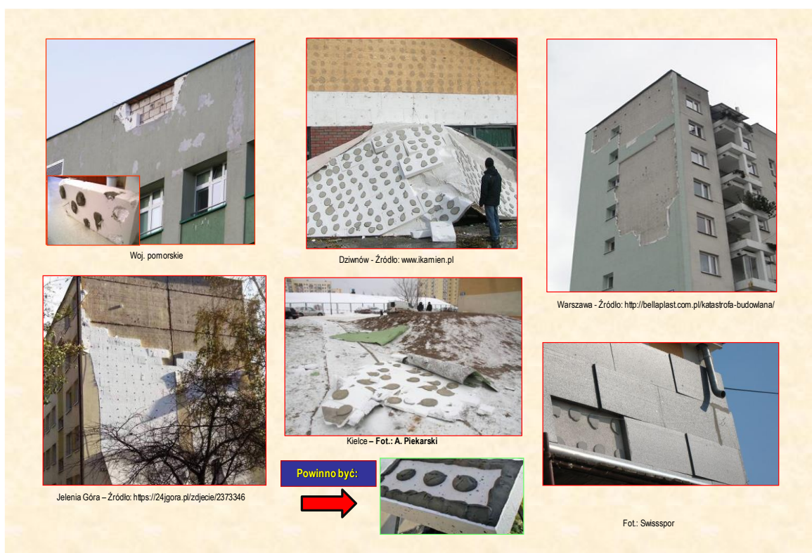
Fot. 13÷18 Skutki błędów wykonawstwa prac dociepleniowych
